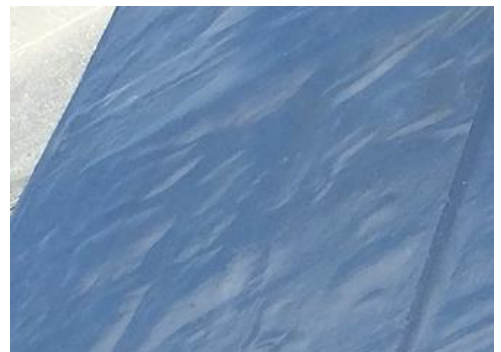
水打ち過多時のシート膨れ
